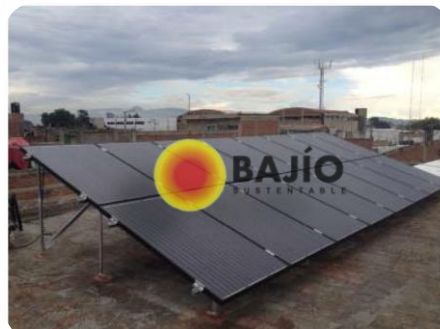
León, Gto 3.360 Kwp
