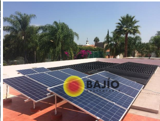
León, Gto 3.35 Kwp
