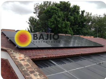
León, Gto 3.360 Kwp
