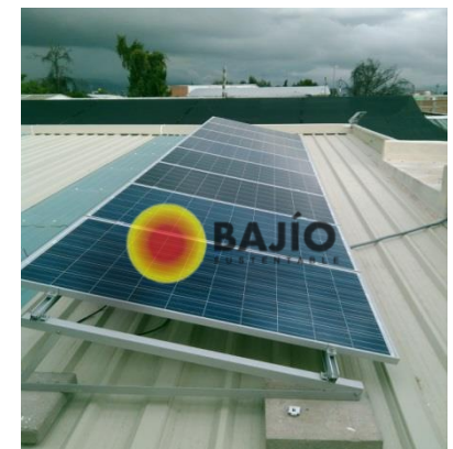
León, Gto 2.0 Kwp
