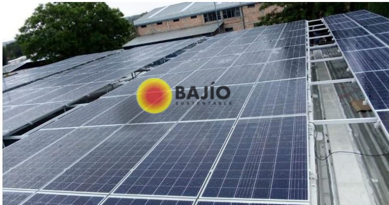
León, Gto 47.52 Kwp
